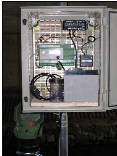
Die zentrale Loggereinheit (grün) wird durch Solarstrom oder Batterie (unten rechts) gespeist. Über Modem (Mitte rechts) werden Alarmnachrichten gesendet oder Daten abgefragt.
