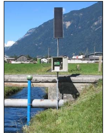
Die kompakten Messstationen sind flexibel einsetzbar und können bei Bedarf (veränderte Dispositive aufgrund des Baufortschritts) rasch umplatziert werden.
