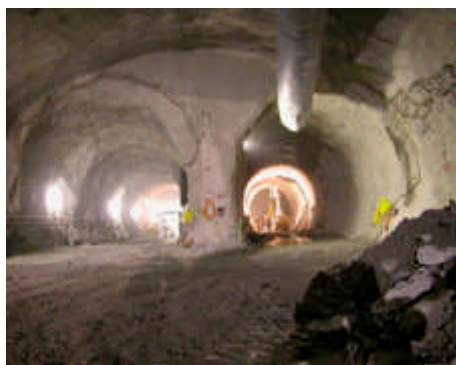
Ausgebrochener Bereich des Tunnelwechsels- und der Hauptröhre West.
