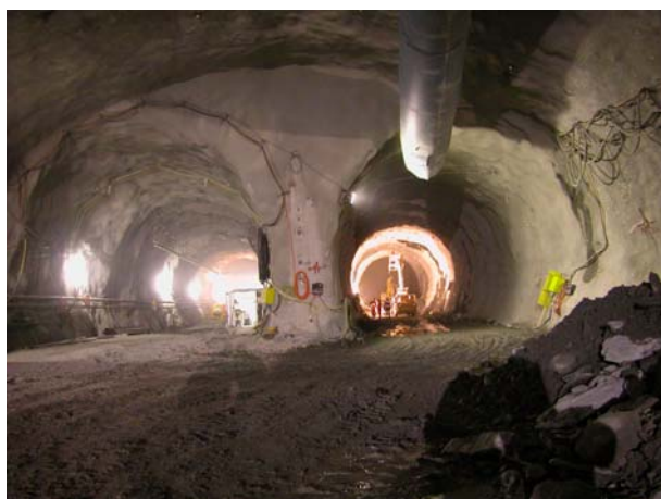
Ausgebrochener Bereich, in welchem Tunnelwechsel- und Haupttröhre West zusammenkommen
