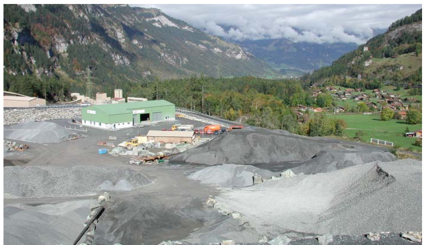
Le chantier extérieur se situe à proximité du village de Mitholz- Blausee. Des mesures particulières ont dû être prises pour limiter les émissions de bruit et de poussières.
