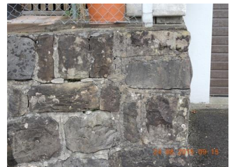
Vorschaden: Mörtelausbrüche, Abtrennungen
