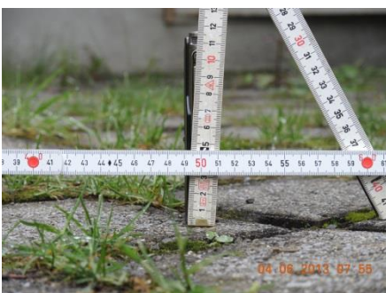
Vorschaden: Belagsabsenkung beim Pflaster (horizontaler 1 m-Meterstab liegt an beiden Enden auf)
