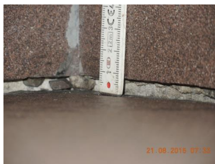
Vorschaden: Belagsabsenkung im Plattenbelag (Fugenhöhe ab Boden 8 mm anstatt 4 mm)
