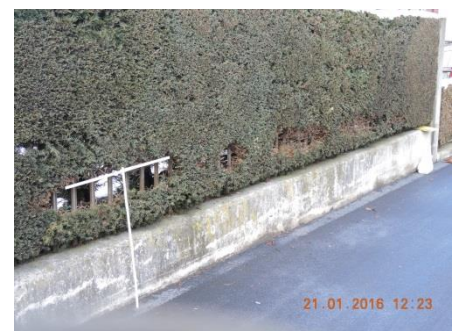
Schäden durch Baumaschinen (heisse Abgase der Strassenwalze)
