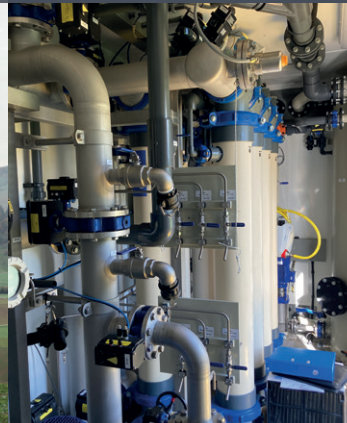
Nanofiltrations-Pilotanlage in Cudrefin, Schweiz
