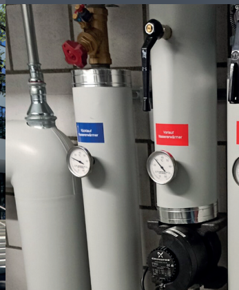
Energetische Betrieboptimierung AXA, Schweiz
