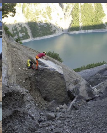
Systèmes d'alarme en cas de coulées de débris et d'avalanches pendant les travaux de construction, Livigno (I)
