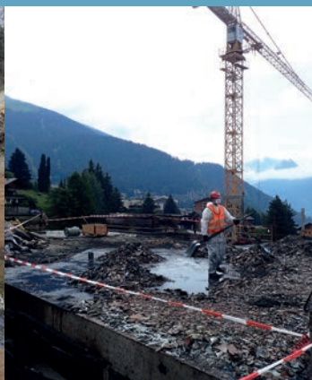
Décontamination après incendie, Verbier, Suisse
