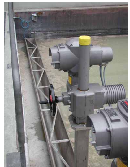
Bild rechts: Neue, vollautomatische Abzugsvorrichtung für den Schwimmschlamm der Vorklärbecken
