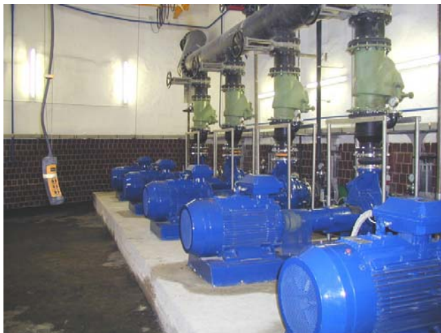
Les capacités de pompage requises exigent la mise en œuvre de grosses pompes et de tuyauteries de forts diamètres.
