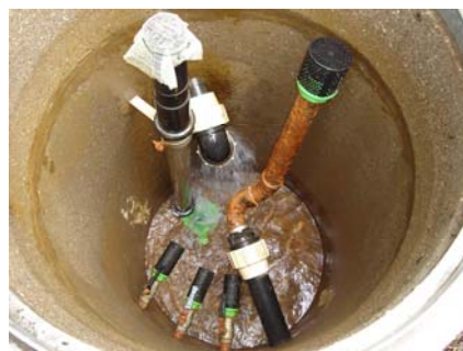
Dettaglio della camera dove verrà convogliata l'acqua trattata
