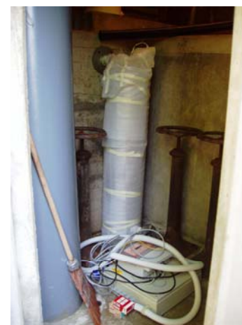
Fase di installazione della lampada UV
