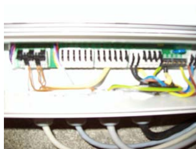
Dettaglio quadro elettrico
