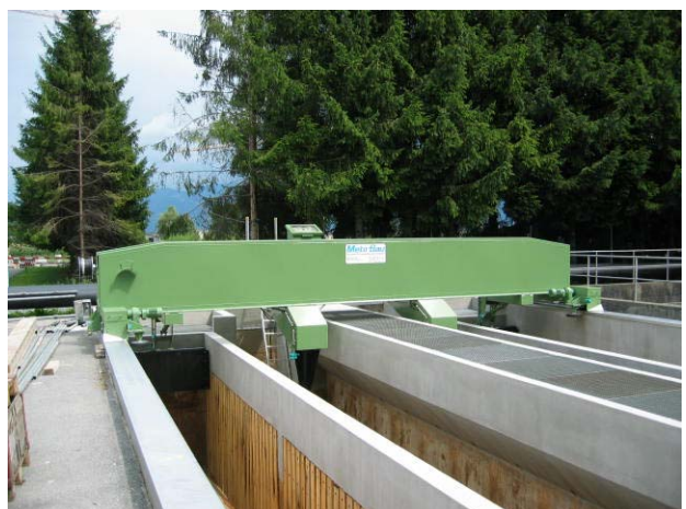
Sanierter belüfteter Öl- und Sandfang mit Sandräumer
