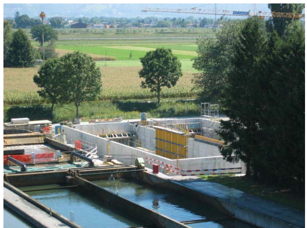
Bestehender Beckenblock mit zusätzlicher Erweiterung für Nitrifikation und Denitrifikation
