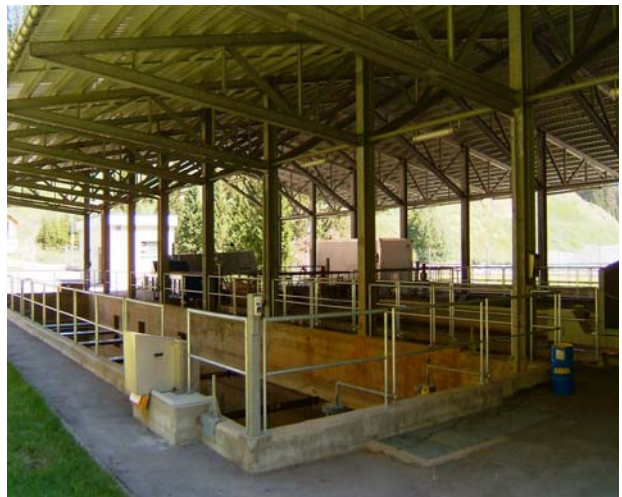
Mechanische Reinigungsstufe und Nachklärung
