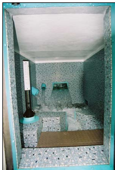
Vasca di raccolta delle acque sorgive
