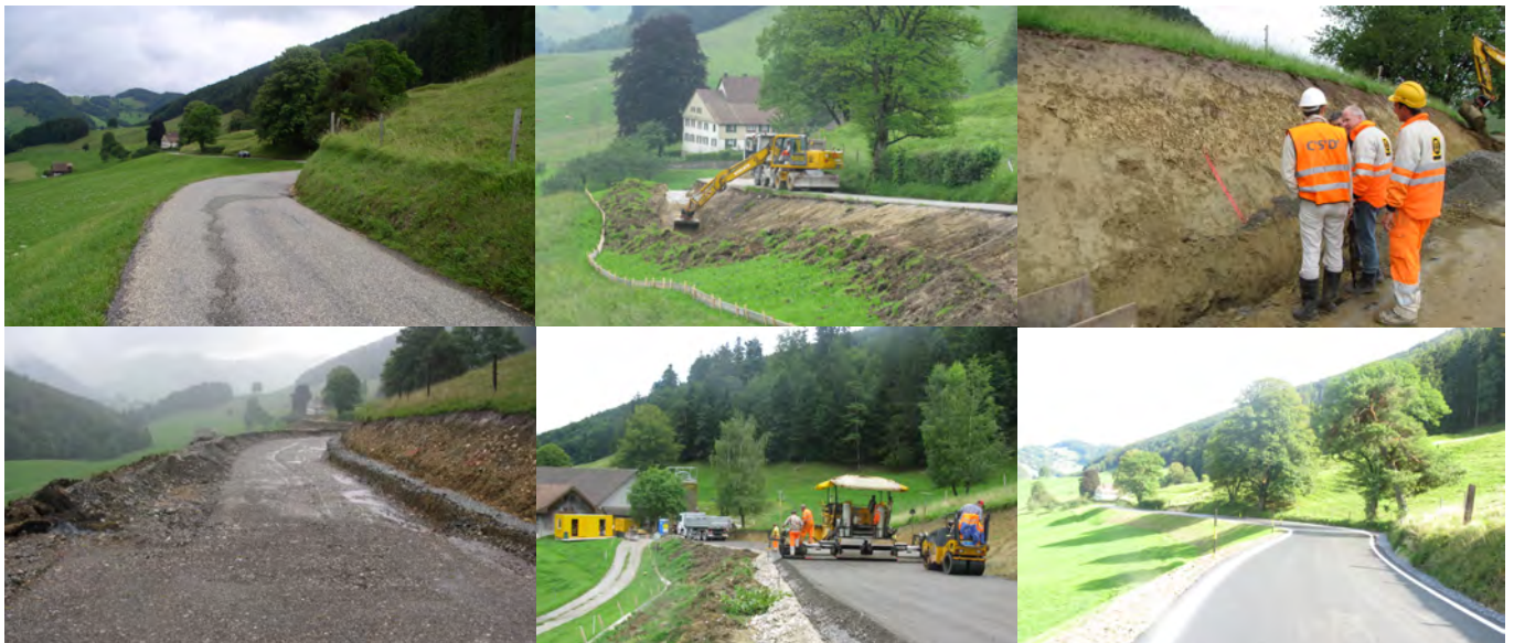
Bachtalenstrasse vor den Instandstellungsarbeiten: Ausbau der Breite von 3 bis zu 5 m. Die Linie musste so gewählt werden, dass der Hang minimal angeschnitten wird.
