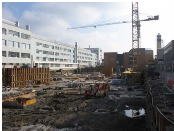
Fond de fouille : des mesures de vibration ont permis d'assurer que la mise en place des palplanches soit compatible avec les activités des laboratoires voisins du chantier
