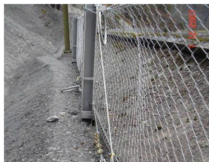
Abrollschutz auf der Halbgalerie
