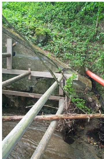
Mur d'aile endommagé de l'aqueduc
