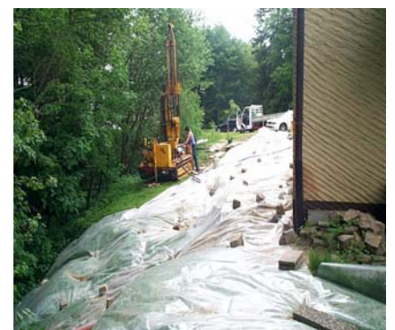
Vue de la tête du glissement depuis l'angle sud-est de la villa. On devine les cicatrices d'arrachement sous les bâches plastiques
