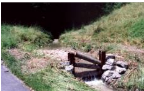
Überlasteter Kiesfang am Zopfbach: hinter dem Holzrechen aufgestautes Geschiebe und seitliche Überschwemmung (niedergedrücktes Gras)
