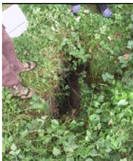
Effondrement du sol sous l'effet de l'érosion
