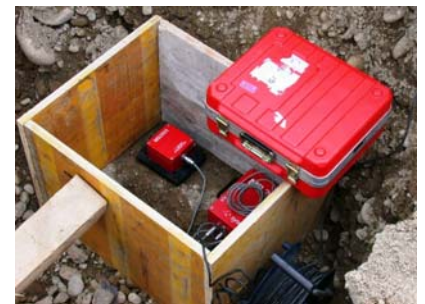
Überwachung Starkstrom-Kabelblock, mit triaxialem Erschütterungsmessgerät MR2002
