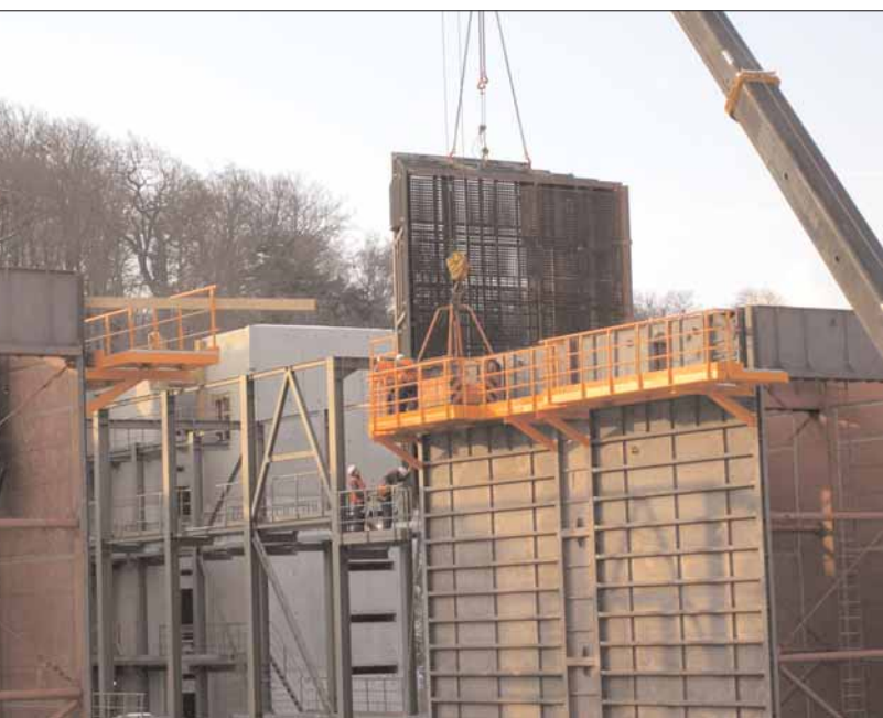
Insertion d'une grille à l'entrée de l'électrofiltre.
