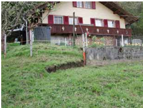
Foto 4.3: Anriss bei Stützmauer
