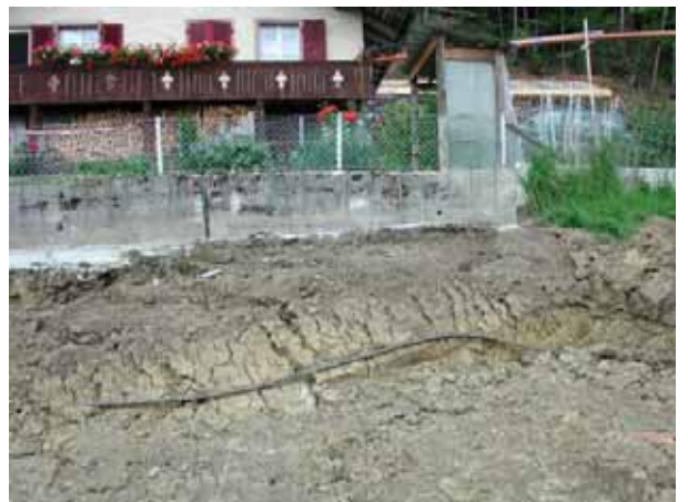
Foto 4.4: Zustand vor Sanierung der Stützmauer
